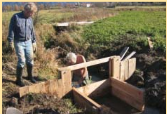
Montage der regulierbaren Stauvorrichtung in Isny. Foto: Rita Strieckmann
