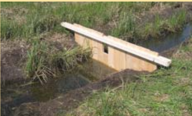
Stauvorrichtungen wie diese wurden in Salem installiert. Foto: Dieter Schmid
